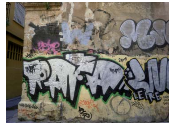
Fig. 85: Fotografía de las manchas y de la suciedad presente en una fachada del centro histórico de la ciudad de Valencia (la autora).
