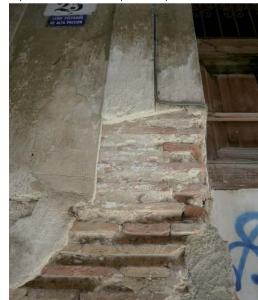
Fig. 112: Fotografía del recercado del edificio en la c/ Engordo nº 25, en la que se aprecian los distintos espesores del enlucido (la autora).
