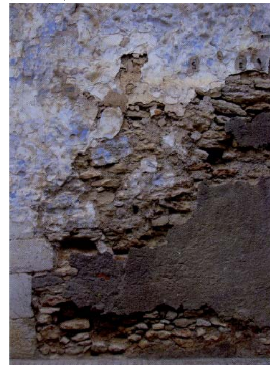
Fig. 94: Fotografía en la que se aprecia una reparación del revestimiento realizada con mortero de cemento (VEGAS, F. y MILETO, C.,2011).
