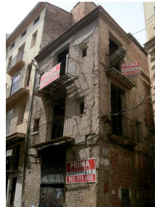
Fig. 1: Edificio de viviendas en la calle Avellanas, en el que se ha eliminado por completo todo el revestimiento histórico externo (la autora).
