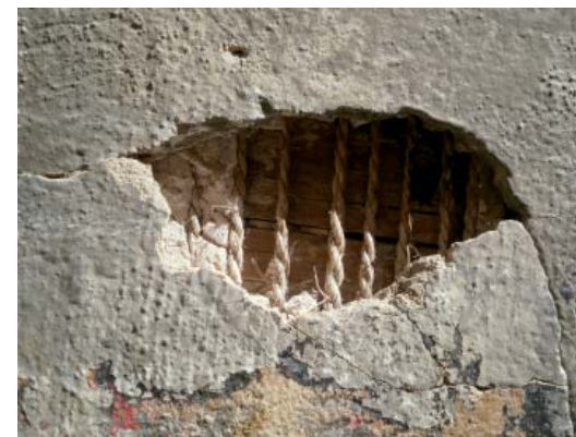
Fig. 35: Fotografía de un dintel con cordel para mejorar la adherencia del enlucido con la madera (la autora).
