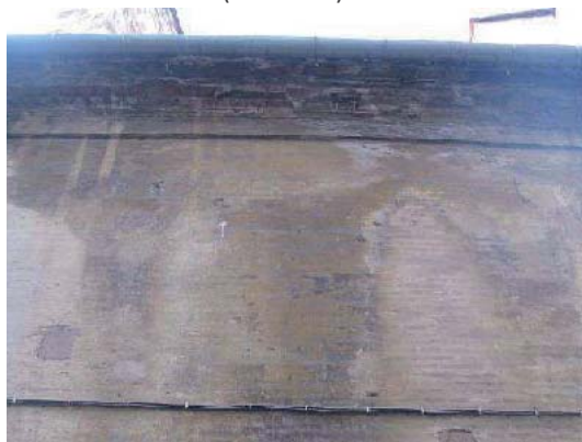
Fig. 86: Imagen de una eflorescencia en una fachada revestida (la autora).
